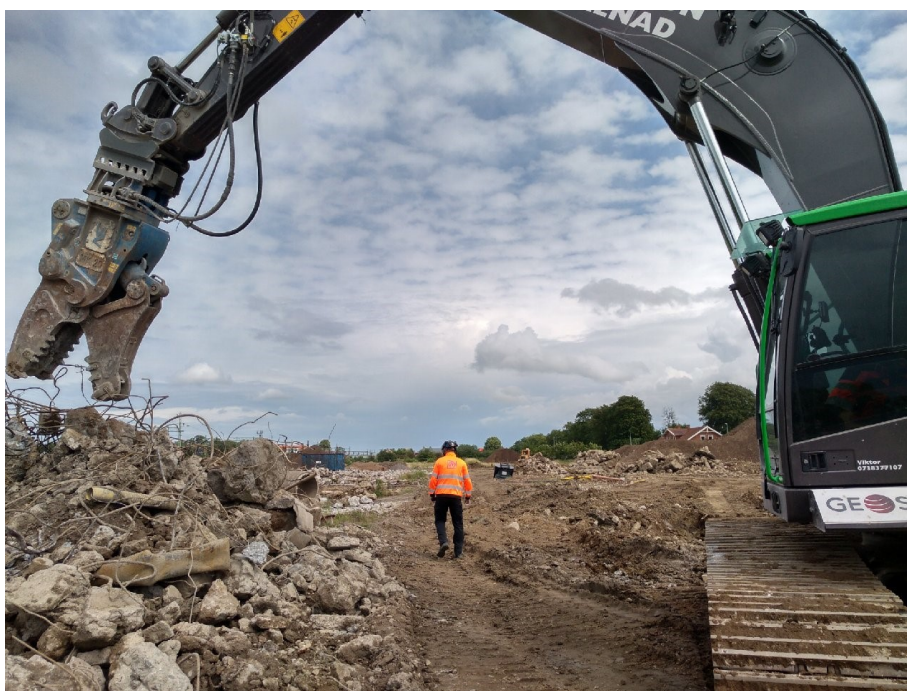
Som väntat var betsvämmorna fulla med gammalt rivningsmaterial och skrot.
